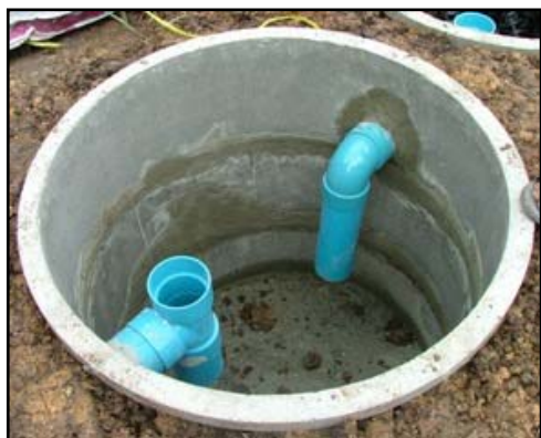
บ่อเกรอะแบบไม่มีฝ้นังกัน
